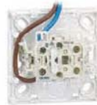
A Cableado en un interruptor.
