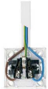
C Cableado en una base de enchufe (en canaleta)
